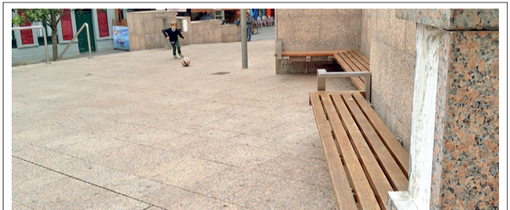
A la derecha, revestimiento desprendido. (L. VENTURA)
